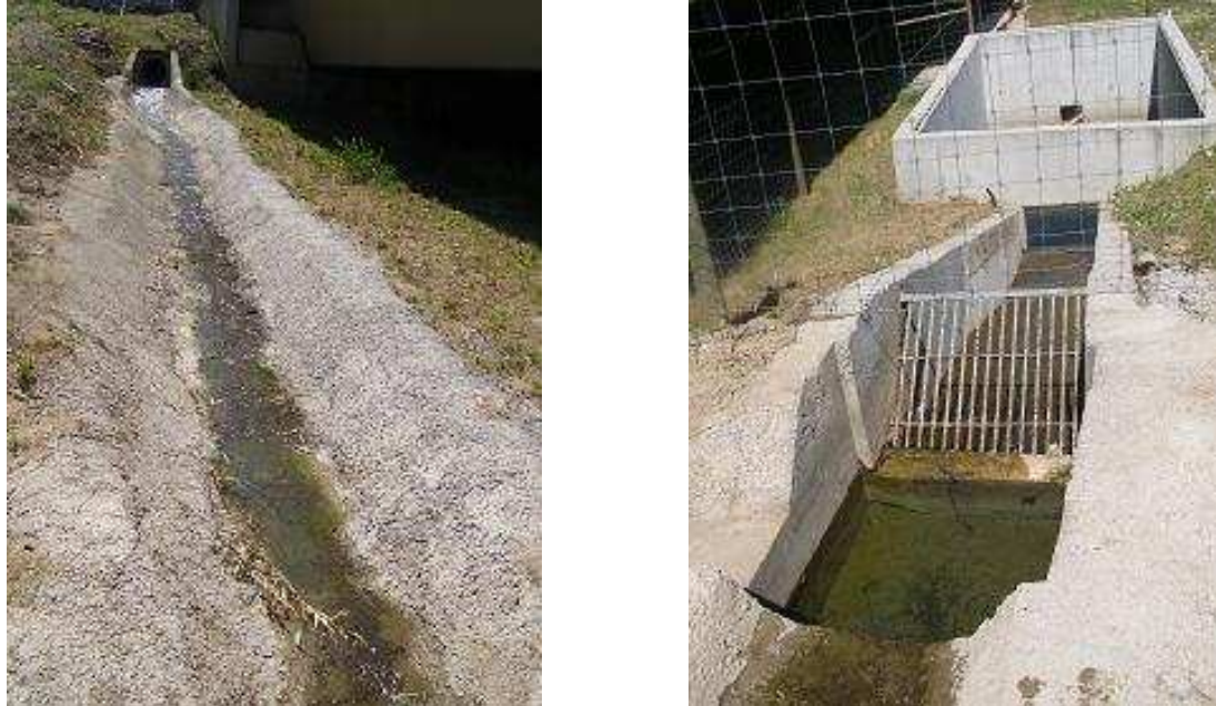
Fig. 26 - Aspecto do escoamento sub-superficial de água para a bacia localizada ao km 1+200, A27/IP9, Estorãos e Ponte de Lima
