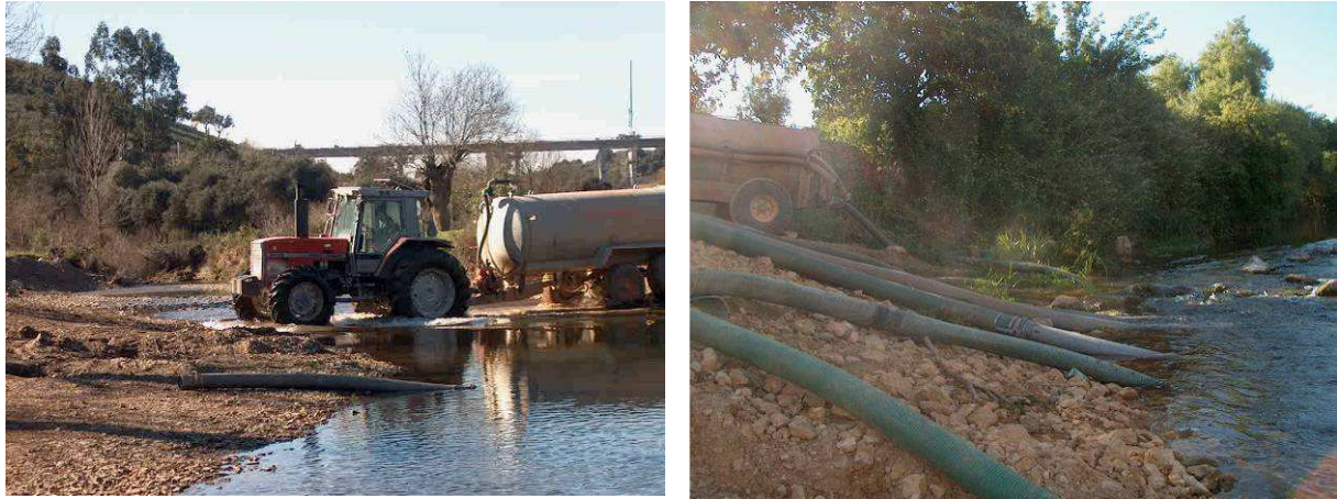
Fig. 47 - Fotos ilustrativas de perturbações induzidas pelas acções associadas à obra da A2 (fotos gentilmente cedidas pela UNL/FCT/DCEA)
