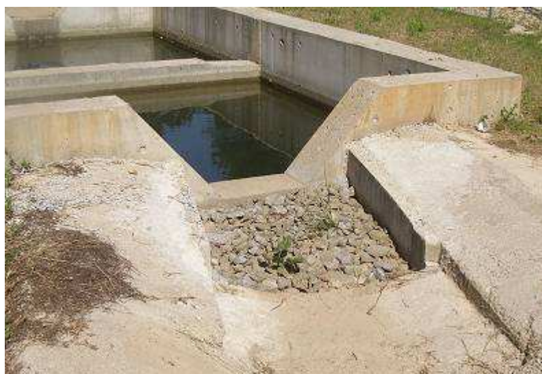
Fig. 25 - Aspecto da caixa com seixo, à saída do sistema localizado ao km 1+030, na A27/IP9, Nogueira-Estorãos
