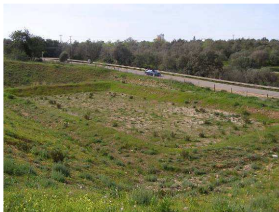
Fig. 10 - Bacia de infiltração do sistema designado BTA ao km 38+656, A22/IC4, Alcantarilha – Guia
