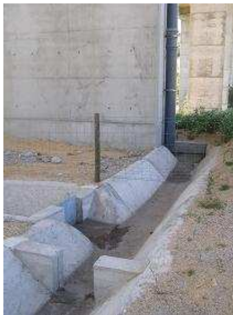
Fig. 17 - Sistema de drenagem e by-pass do viaduto para a bacia ao km 25+550, A24/IP3, Pedras Salgadas/EN103 (8 de Maio de 2007)
