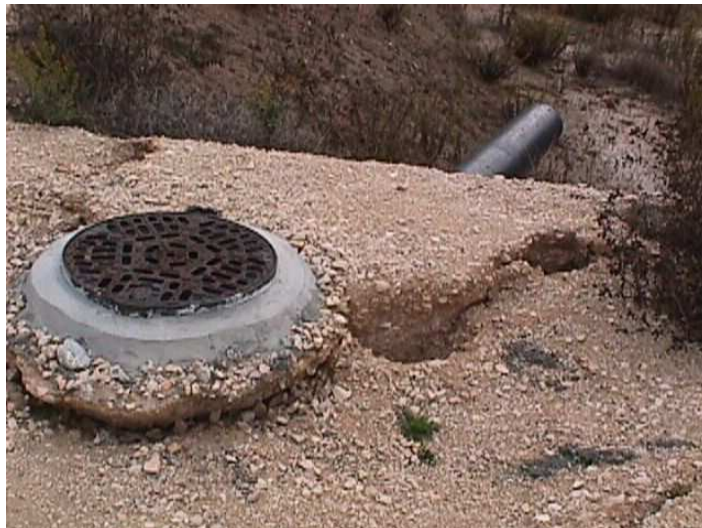
Fig. 23 - Aspecto dos colectores de descarga na bacia de tratamento em terra (Etapa 2)
