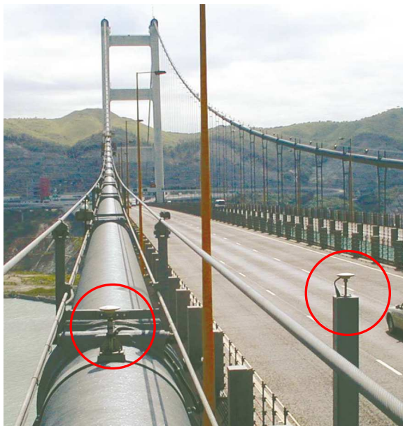
(a) Receptor no cabo de suspensão e receptor no tabuleiro sobre um suporte de betão
