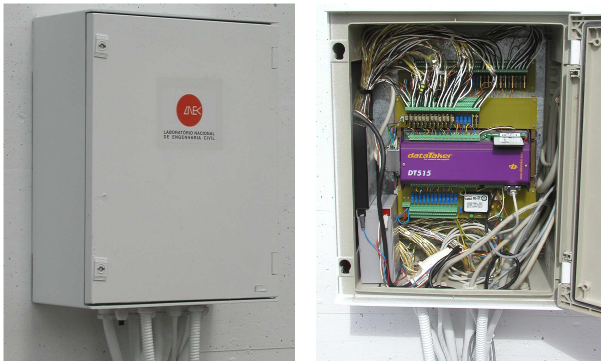
Figura 2.44 – Datalogger instalado na Ponte Rainha Santa Isabel, em Coimbra
