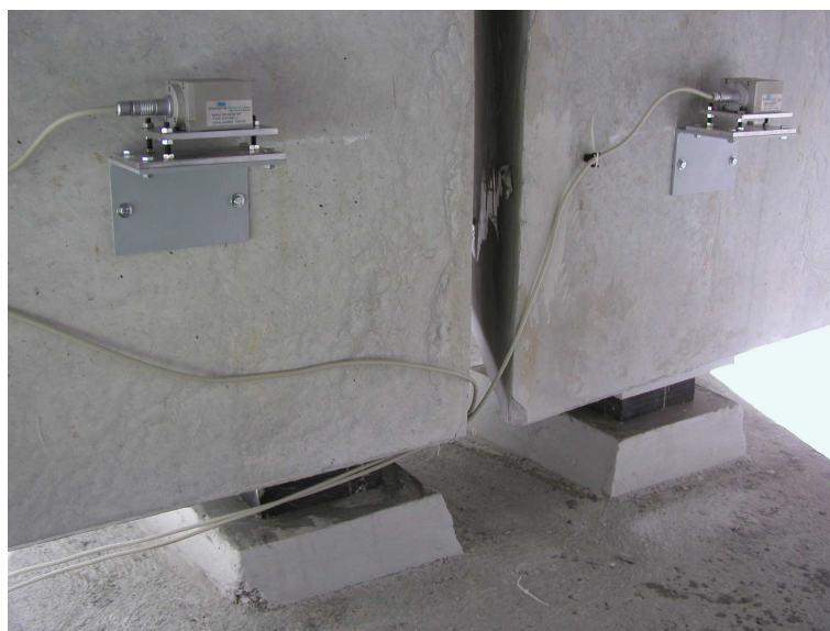
Figura 2.19 – Inclinómetros do tipo servo instalados na Ponte sobre o rio Felgueiras na A24
