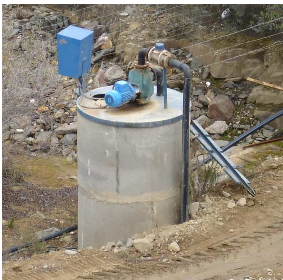
Figura 7.15 – Poço de drenagem/bombagem - IBR
