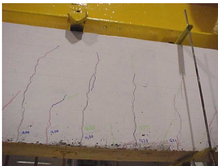
Figura 6-12 - Viga HSS1_C35_d12: a azul medição da espessura das fendas, para nível de força correspondente ao estado limite de utilização.
