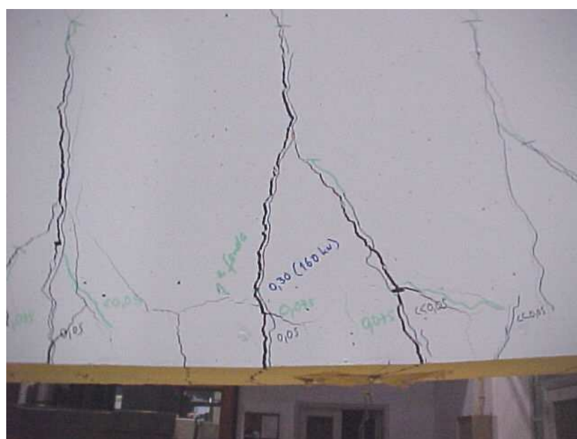
Figura 6-14 - Pormenor da fendilhação da viga AISI316_C35_d16.
