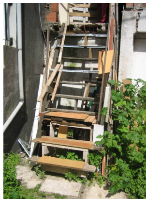
Figura 17 – Escada de construção precária
