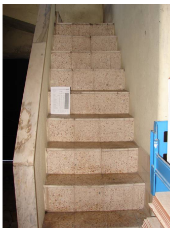
Figura 23 – Escada com degraus de altura excessiva
