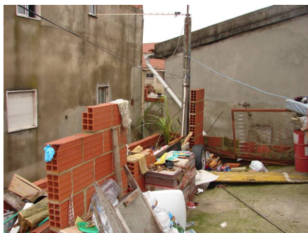
Figura 16 – Aspecto geral de zona de cobertura em terraço, sem acabamento ou isolamento
