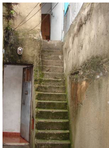
Figura 24 – Escada com desenvolvimento irregular e de largura não-regulamentar, com ausência de dispositivo contra queda
