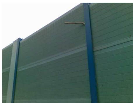
Fig. 27 - Exemplos de problemas de deficiente selagem
