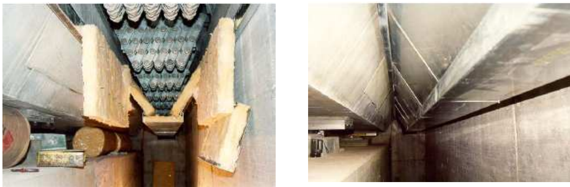
Fig. 36 – Fotografias de aplicação do dispositivo de redução de ruído para juntas de dilatação, na zona inferior do viaduto [ www.maurer-soehne.de ]
