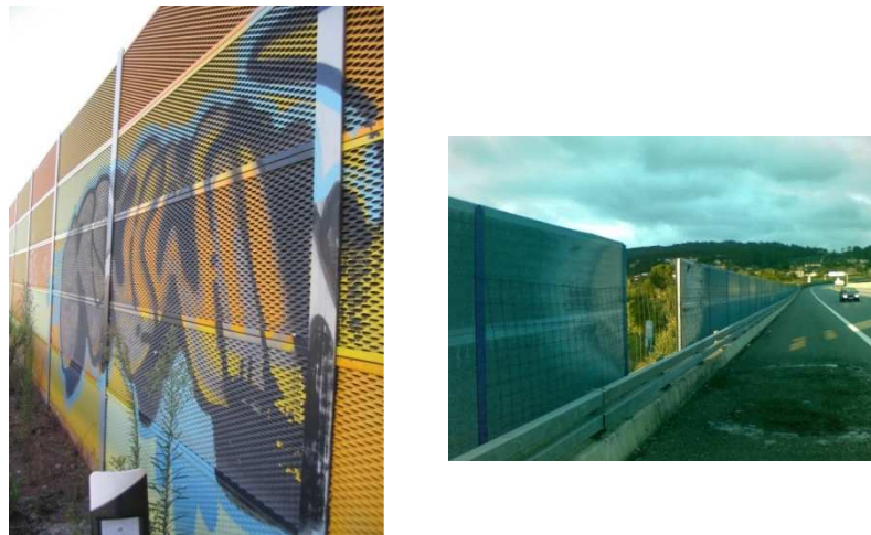
Fig. 30- Exemplos de ausência de programas de manutenção adequados
