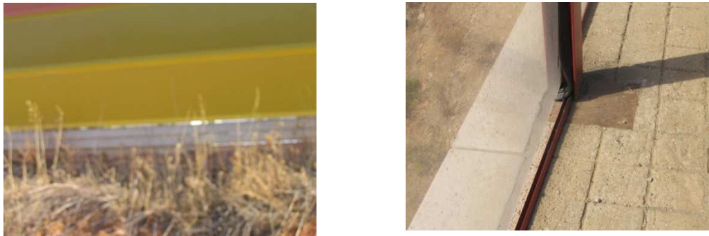
Fig. 28 - Exemplos de problemas de deficiente união entre estruturas
