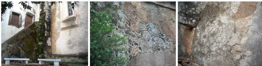
Fig. 3 – Algumas anomalias correntes em paredes de edifícios antigos: humidade de infiltração, destacamento do reboco novo e erosão do reboco antigo (fendilhação)
