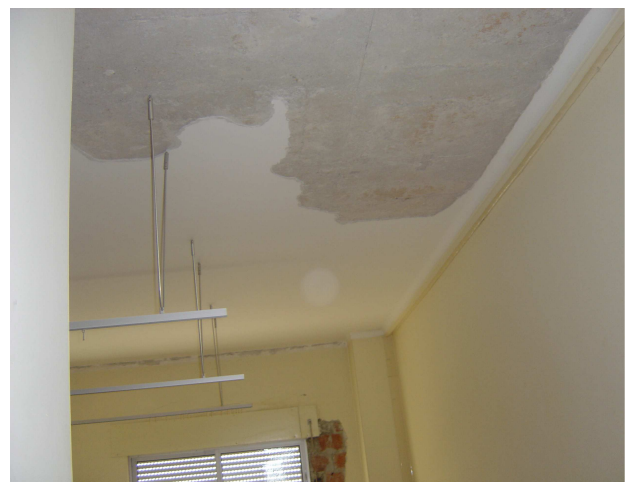
Fig. 6 – Quarto revestido com um revestimento pré-doseado de gesso: perda de aderência e destacamento
