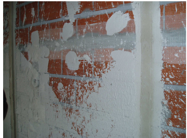
Fig. 2 – Aplicação de revestimento pré-doseado de gesso em parede de alvenaria de tijolo.
