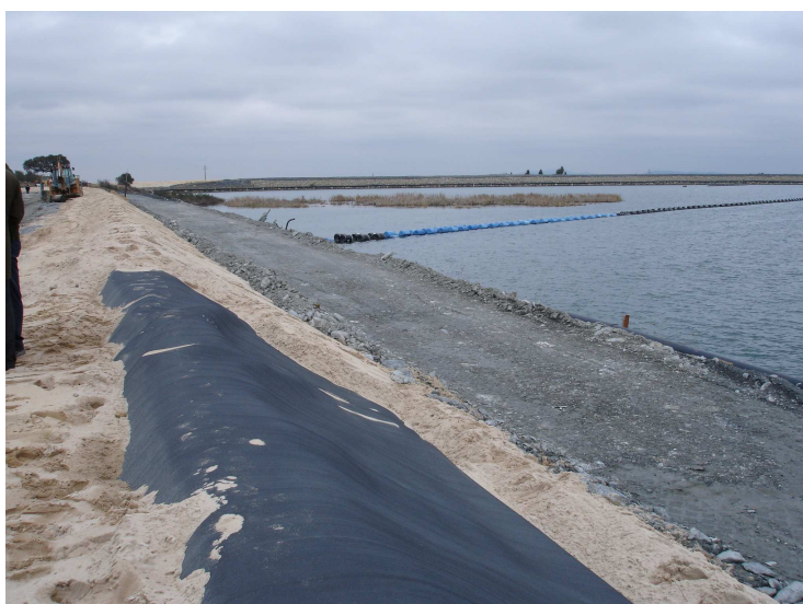
Figura 7.9 – Construção do último alteamento. Zona do coroamento da geomembrana e sua camada superior para protecção contra o punçoamento
