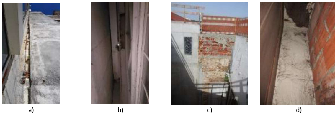
Figura 5 – Estado de conservação da envolvente: a) e b) junta entre a Ala poente e a Ala sul; c) paredes inacabadas no saguão poente e d) sinais de humidade na janela emparedada
