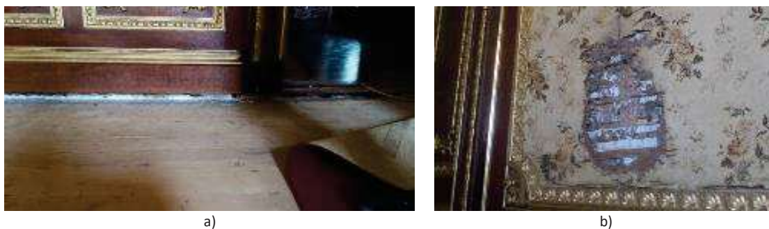
Figura 1 – Afastamento entre o pavimento e a parede interior no Toucador da Rainha (a) e sinais de infestação na parede interior norte (b)
