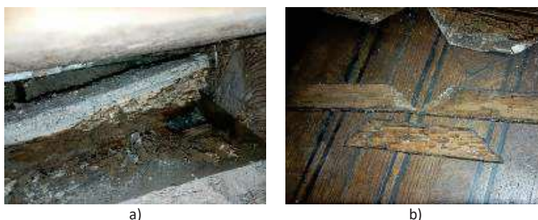
Figura 3 – Vestígios de ataques por térmitas subterrâneas: a) tarugo observado através da janela de inspeção aberta no Toucador da Rainha e b) pavimento do Atelier do Rei.
