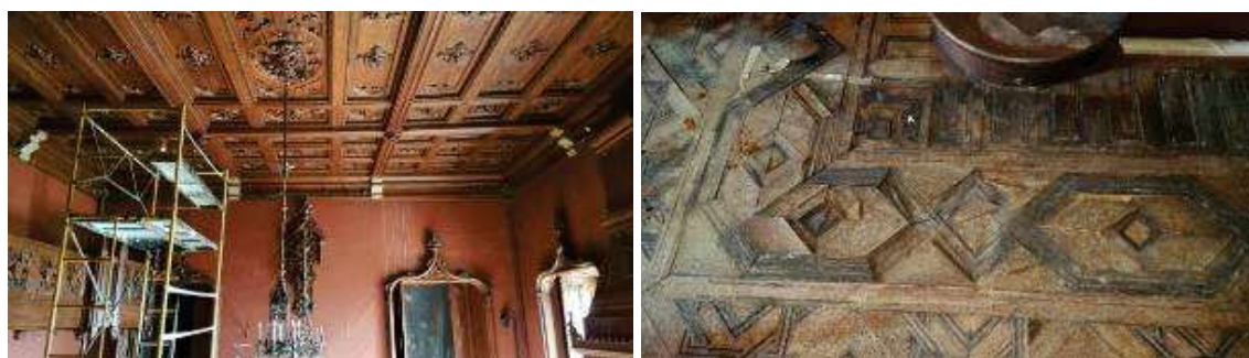
Figura 4 – Parede com sinais de escorrência antigos e pavimento degradado no Atelier do Rei
