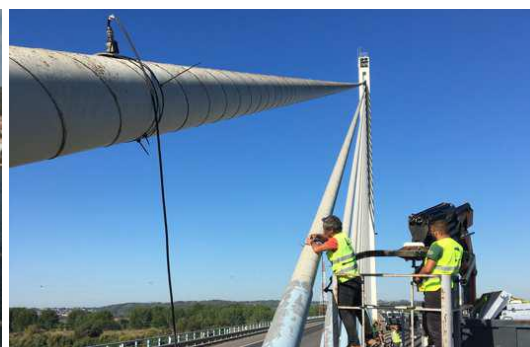
Figura 3.5 – Medição das forças nos tirantes da Ponte Salgueiro Maia
