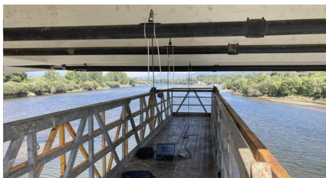
Figura 3.7 – Medição das forças nos cabos de pré-esforço exterior da Ponte de Lanheses
