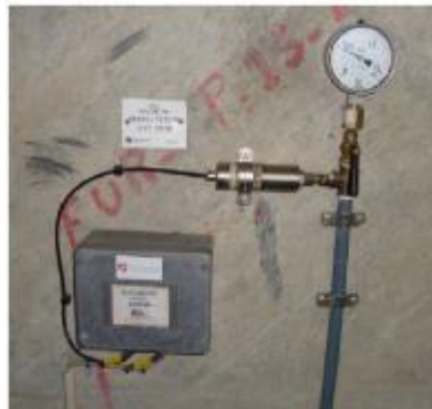
Figura 3.12 – Manómetro e dispositivo de recolha automática de um piezómetro, instalado na fundação de uma barragem de betão
