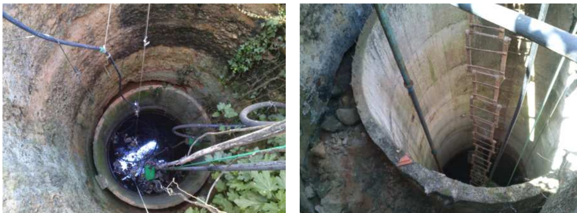
Figura 5 – Poços tradicionais de largo diâmetro (2,5 m) adequados para infiltração de água pluvial recolhida dos tetos das estufas da Campina de Faro
