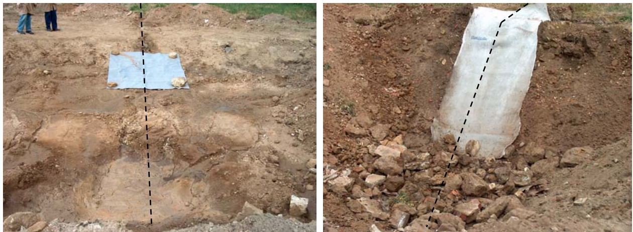
Figura 2.43 – Esquerda - implantação do geotêxtil não tecido. Direita – Geossintético bentonítico. O perfil encontra-se assinalado a tracejado.
