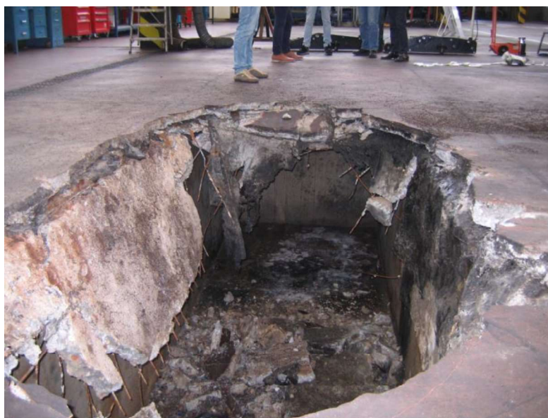
Figura 1 - Imagem do abatimento do pavimento da oficina do DRMM/CML, em 19 de maio 2020
