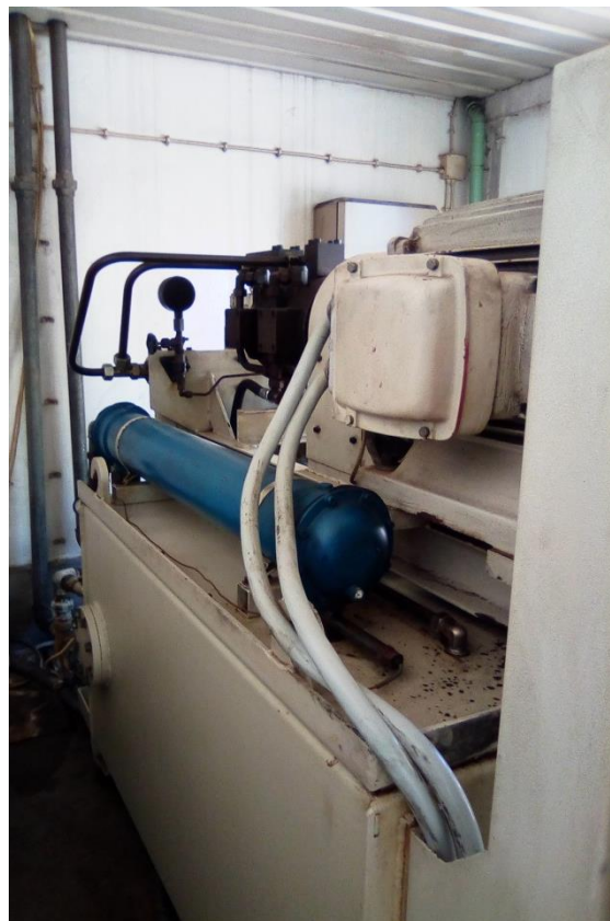
Figura 3.2 – Imagem da unidade energética óleo-hidráulica ligada à torre de arrefecimento
