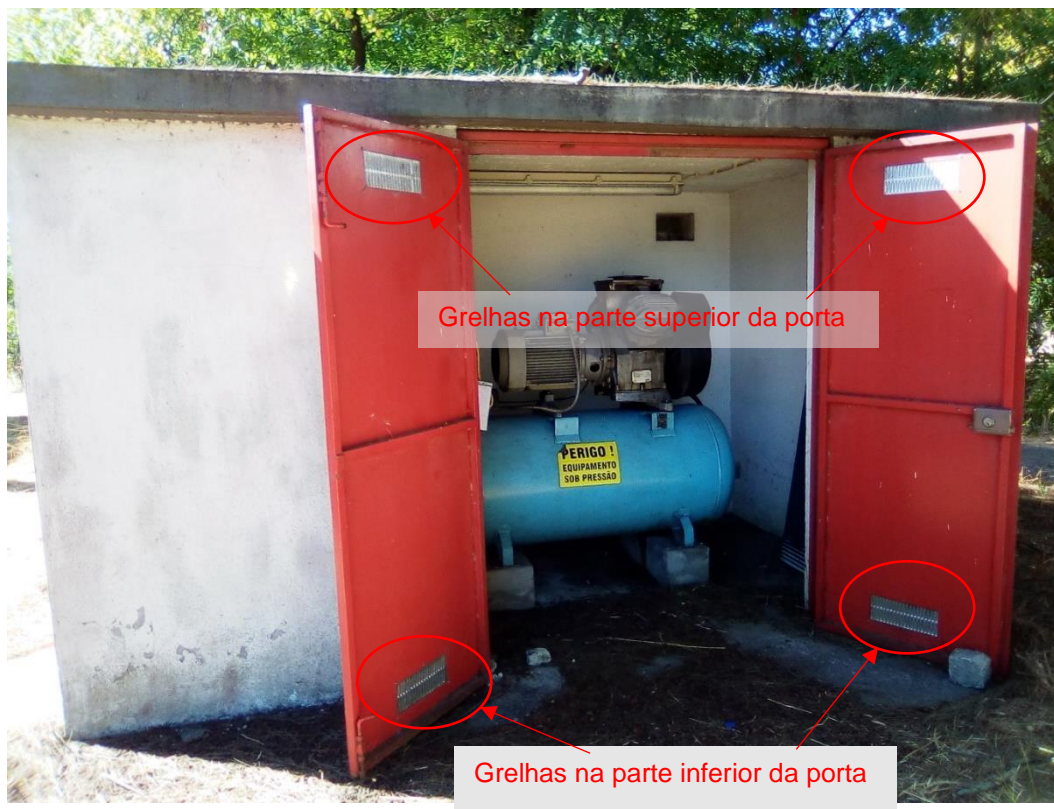
Figura 3.2 – Grelhas de ventilação na porta localizada na fachada virada a Norte
