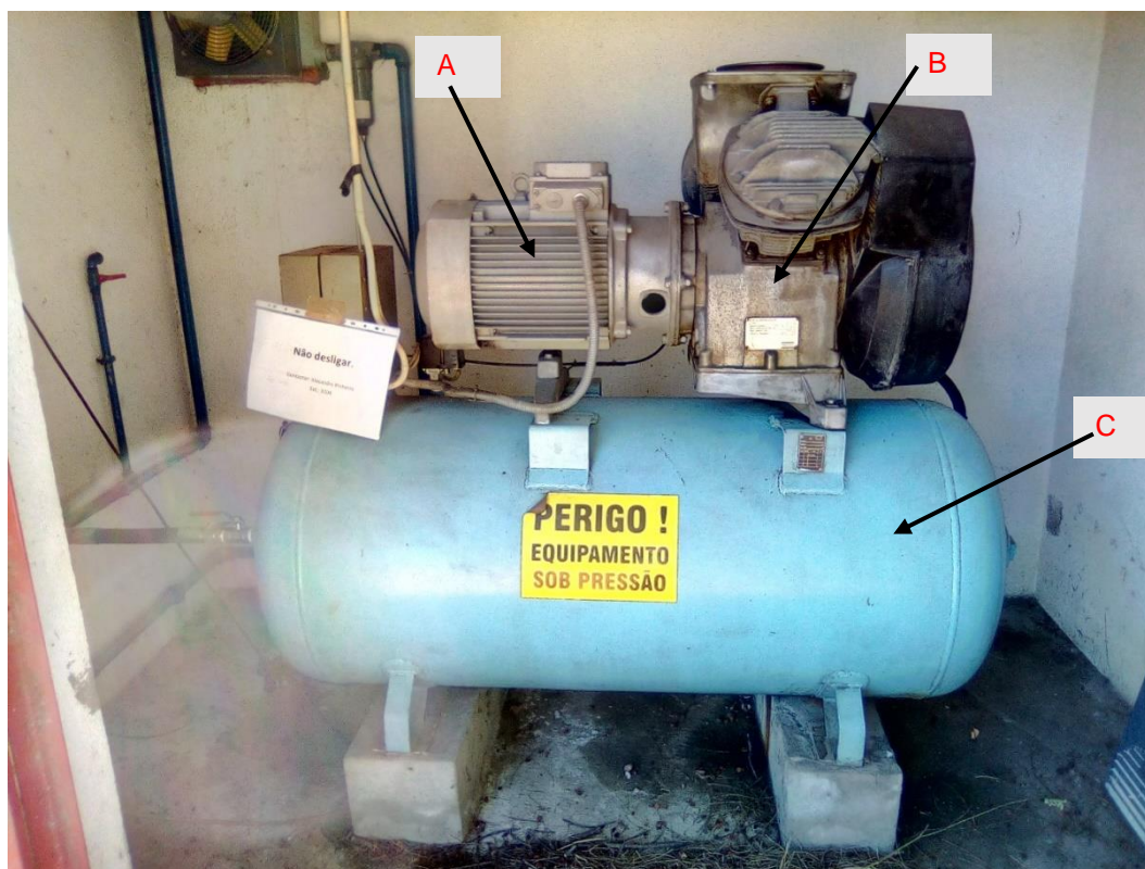
Figura 3.3 – Compressor Atlas Copco Airlet LE11: A – Motor elétrico; B – Compressor; C – Reservatório
