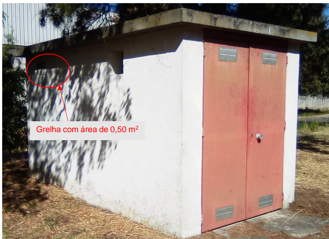
Figura 4.2 – Localização e área da grelha de exaustão de ar quente
