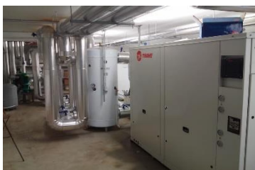
Figura 6 – Bomba de calor
