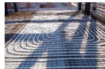
Figura 8 – Tubos permutadores numa laje (circuito secundário)
