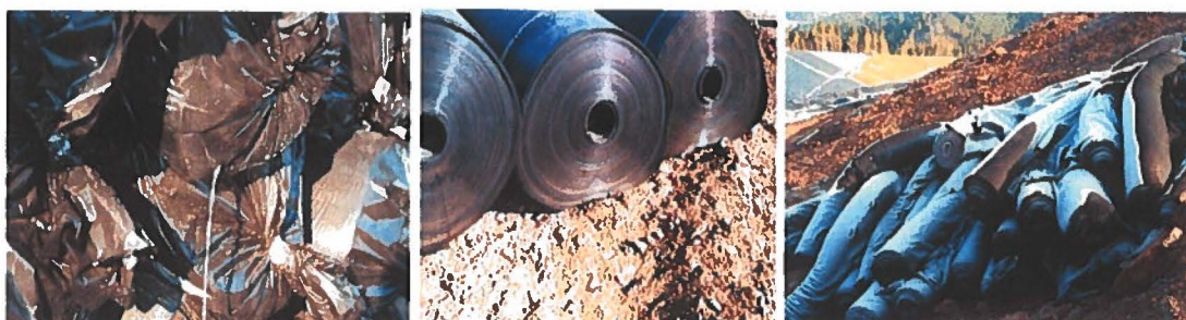
Figura 5 – Exemplos de armazenamento inadequado de geossintéticos em obra
