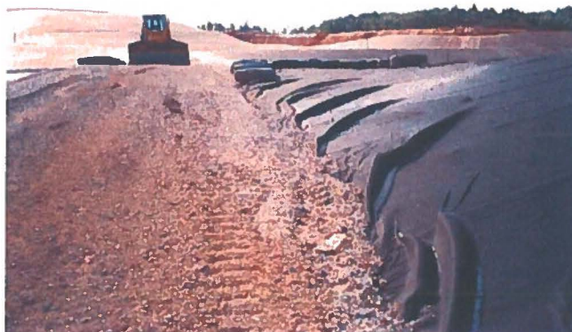
Figura 4 – Dobras na geomembrana junto do pavimento das rampas de acesso ao fundo do aterro
