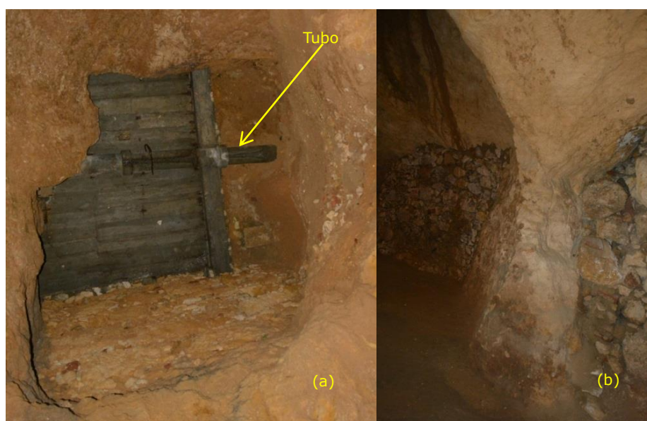
Figura 19 – Zona 8: (a) vista do maciço nas imediações da chaminé CH6; (b) vista do maciço adjacente à parede de alvenaria a norte da chaminé CH6 que necessita de reforço mediante a aplicação de elementos metálicos
