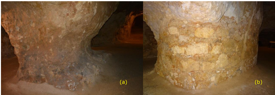
Figura 14 – Zona 4: (a) vista da base do pilar 15 com sobreescavação na sua parte inferior; (b) exemplo da proteção da base de um pilar com sobreescavação mediante o preenchimento das reentrâncias com pedra argamassada
