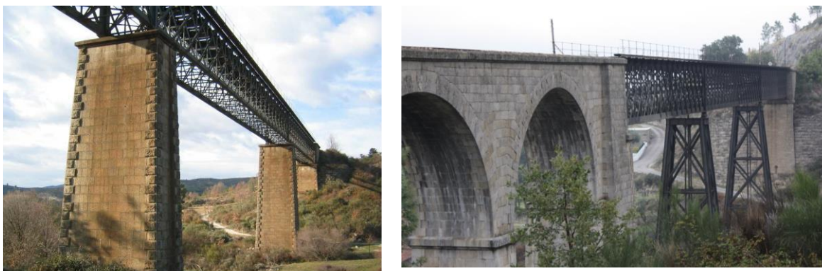
Figura 4 – Pontes de Maçainhas (à direita) e de Gogos (à esquerda) antes da intervenção
