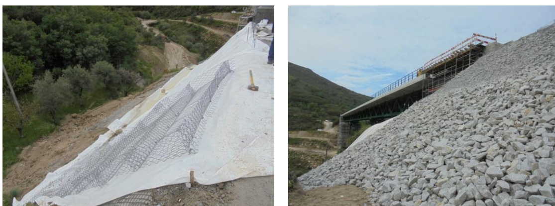
Figura 11 – Instalação do geotêxtil no talude do aterro do encontro da Ponte de Gogos
