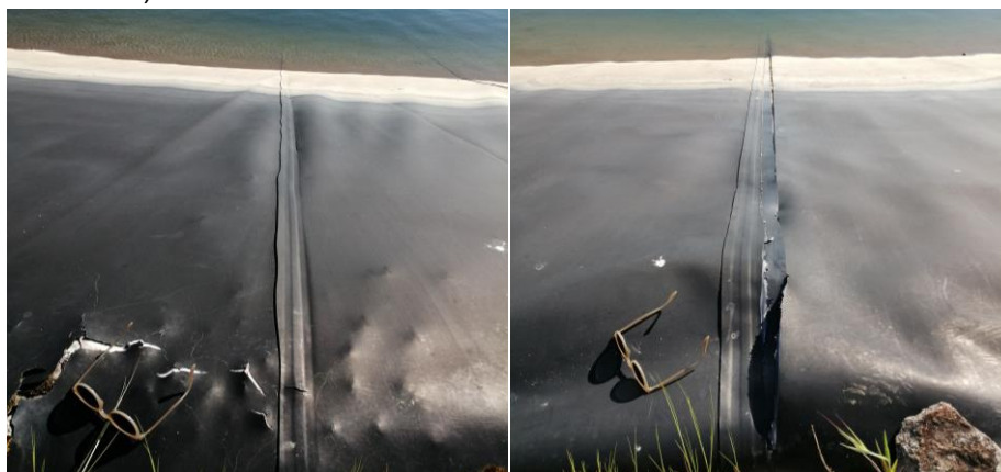
Figura 3 – Exemplos de danos observados junto à crista do talude e às uniões
