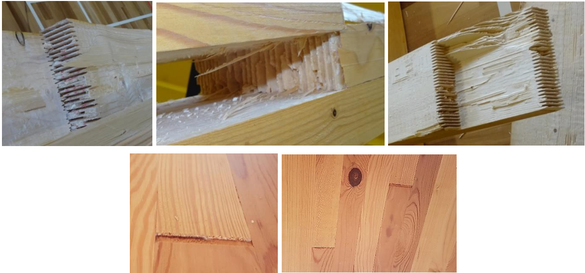
Figura 15. Juntas de colagem com falta de cola e ligações ( finger-joints ) abertas
