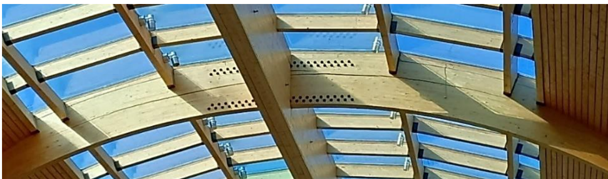
Figura 2. Um dos elementos curvos, com delaminação e fendas ao longo das lamelas
