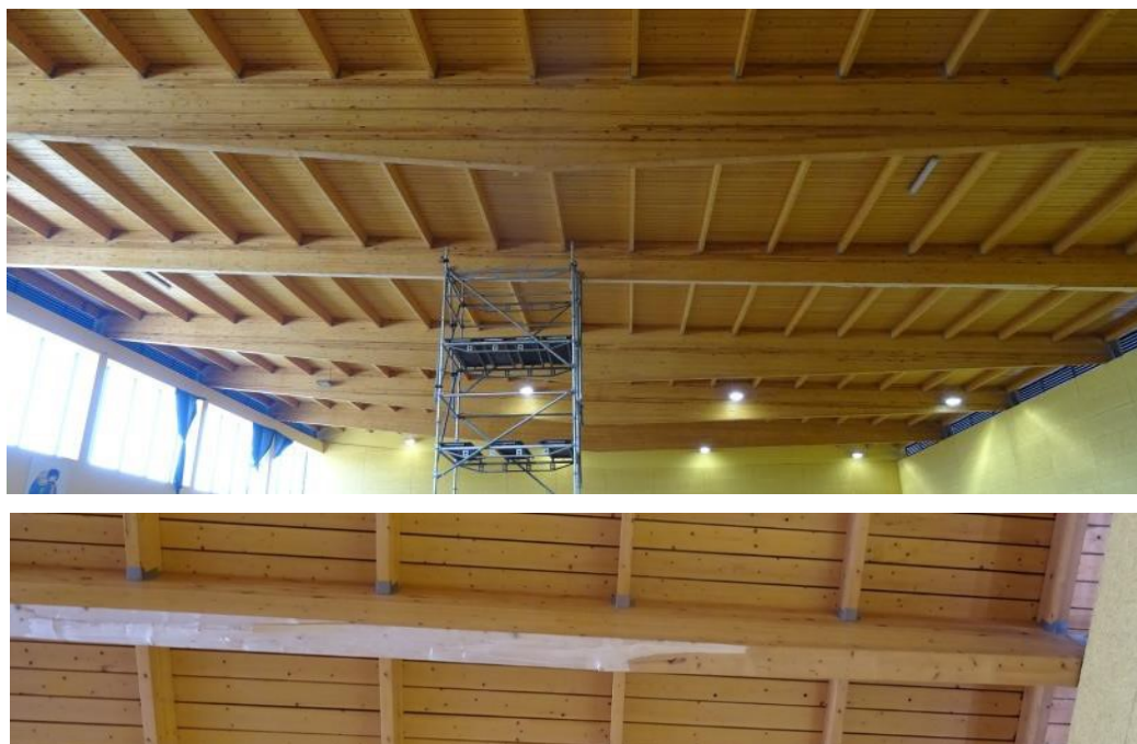
Figura 13. Aspeto geral da estrutura de cobertura. Viga acidentada com escoramento e pormenor da zona de fratura ao longo de uma junta colada (cor branca)
