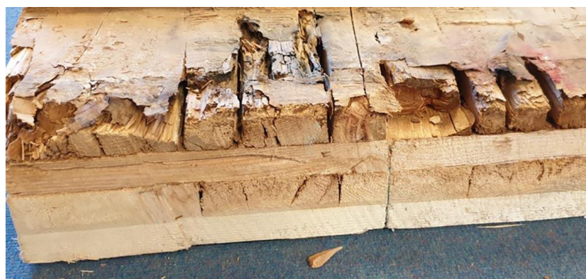
Figura 3. Painel MLCC com degradação por fungo de podridão [21]
