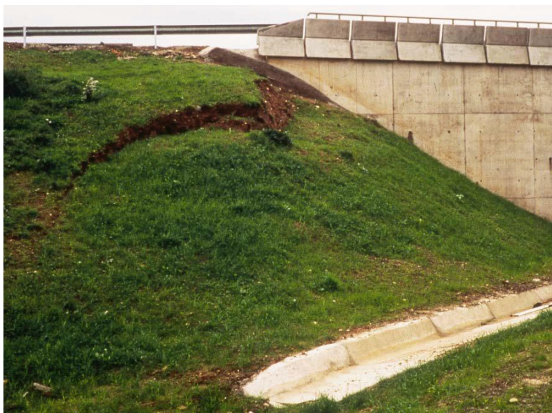
Figura 1-2 – Colapso de um aterro de argila arenosa residual de granito numa estrada em Girona (Espanha) causado por chuva intensa de Outono e com consequência de rotura da laje de transição [Alonso et al. , 2010]
