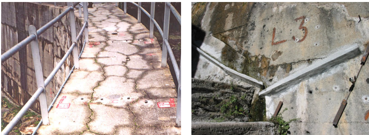
Figura 3 Barragem do Alto Ceira. Fendilhação difusa, do tipo craquelê, no piso do coroamento (à esquerda) e bica no paramento de jusante para coletar repasses pelas fendas (à direita)
