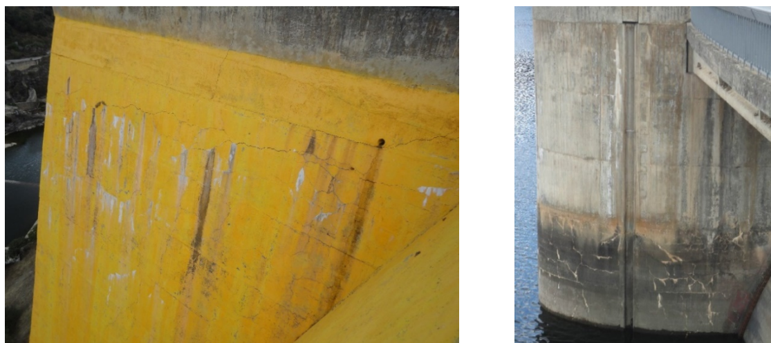
Figura 4. Fendilhação difusa no topo do encontro da margem direita (à esquerda) e na face da margem direita do pilar 1D, a montante (à direita) (fotografias de junho de 2019)
