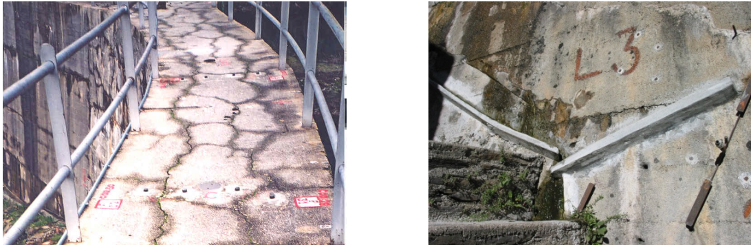
Figura 3. Barragem do Alto Ceira. Fendilhação difusa, do tipo craquelê, no piso do coroamento (à esquerda) e bica no paramento de jusante para coletar repasses pelas fendas (à direita)
