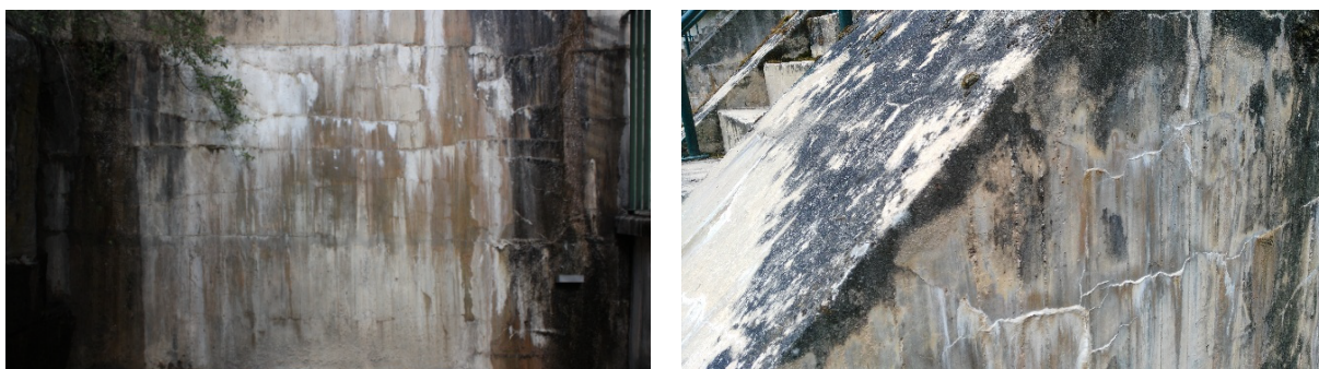
Figura 18. Barragem de Fagilde. Vistas de jusante de um trecho da abóbada direita, em 2015 (à esquerda), e de uma zona do contraforte central, em 2016 (à direita) [29]
