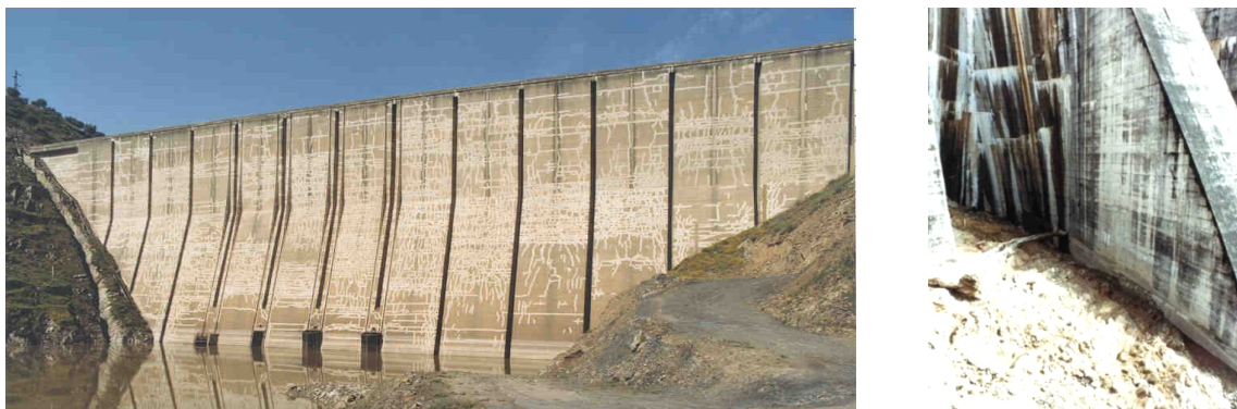
Figura 21. Barragem de Pracana. Fendilhação generalizada do paramento de montante e das almas dos contrafortes (fotografias captadas antes das obras de reabilitação)
