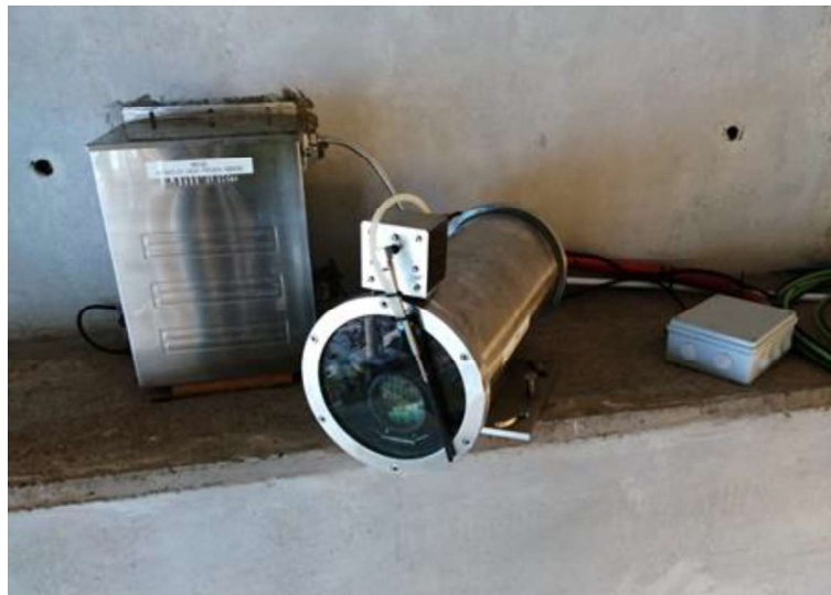
Figura 11. Sistema de monitorização por correlação digital de imagem, montado sobre o pilar P17.4
