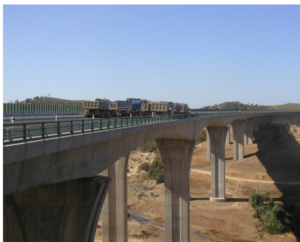
Figura 5 – Ensaio de carga da ponte sobre o rio Arade, na auto-estrada A2
