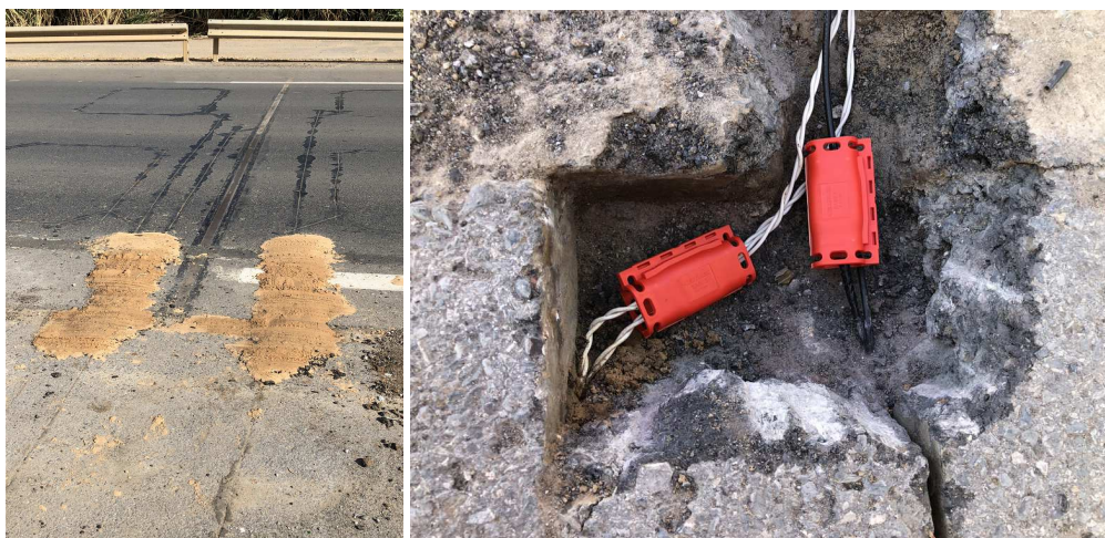
Fig. 5. Recuperação de posto de pesagem em movimento, danificado por seccionamento das ligações dos sensores ao módulo de processamento de sinal, na RN11
