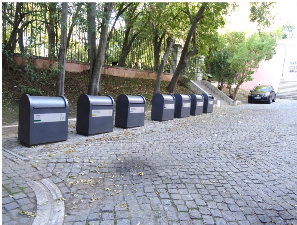
Figura 8 – Palácio das Necessidades (pátio): Localização dos tops dos contentores enterrados após a obra concluída
