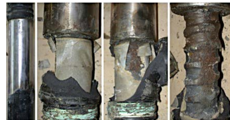
Fig. 4 - Pormenores dum troço da barra de aço na zona de acoplamento e de interface entre os dois componentes do sistema de proteção (massa anticorrosiva sob o acoplador e bainha com calda cimentícia): intacto (à esquerda) e em fases sucessivas de remoção do sistema de proteção.
