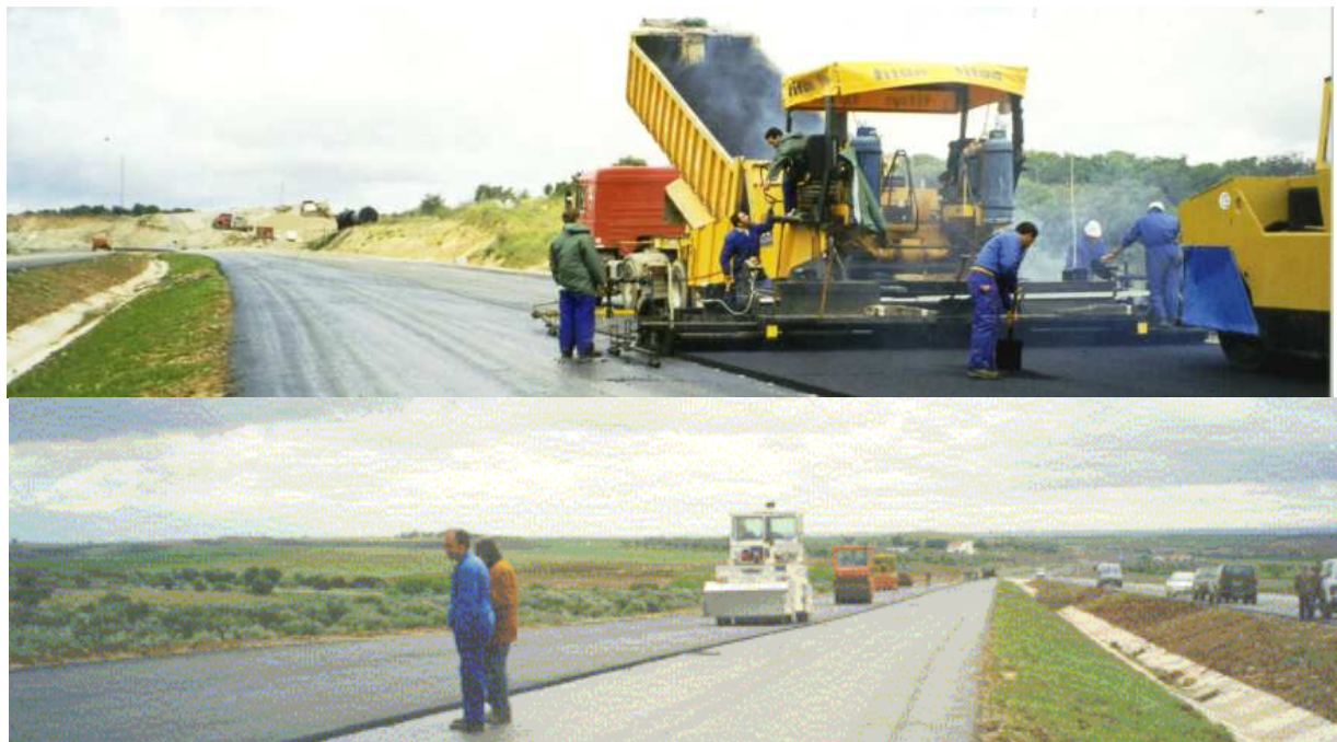
Figura 6.3 – Aplicação, espalhamento e compactação da mistura betuminosa na camada de desgaste do IP7/A6, no sub-lanço em estudo
