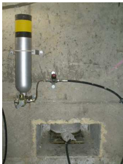
b) Vista dos elementos aparentes dos sistemas de carga de uma das células de fluência instaladas na barragem de Foz Tua
