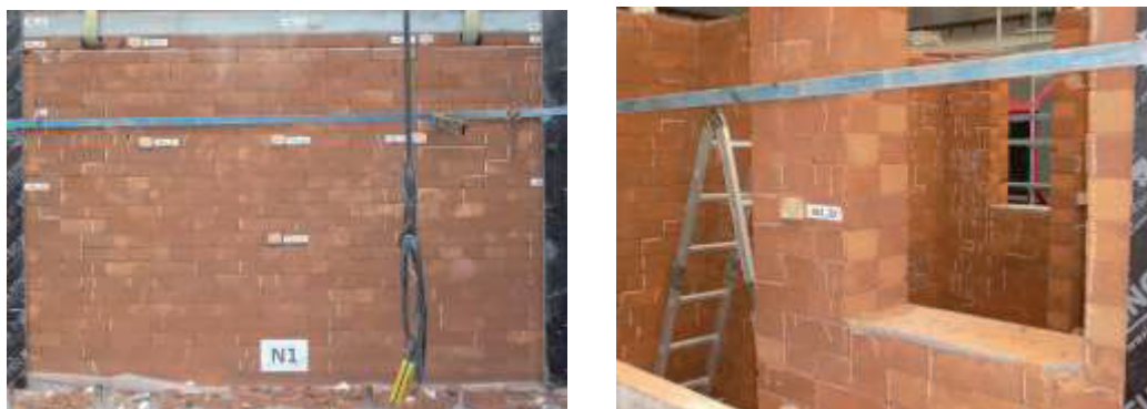
Figura 9: Dano observado no modelo: (a) parede Norte; (b) fachada principal junto à porta de entrada.
