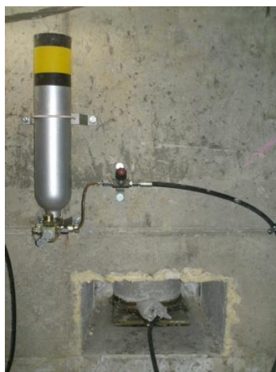
b) Sistema de carga das células de fluência instaladas na barragem de Foz Tua
