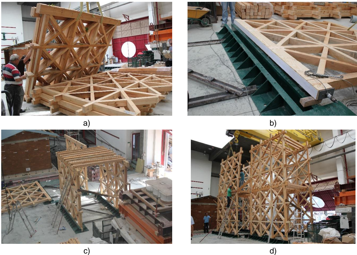
Figura 2 – Montagem dos modelos; a) transporte dos painéis das cruces de Santo André; b) bases do modelo; c) colocação do primeiro piso; d) colocação do segundo piso.
