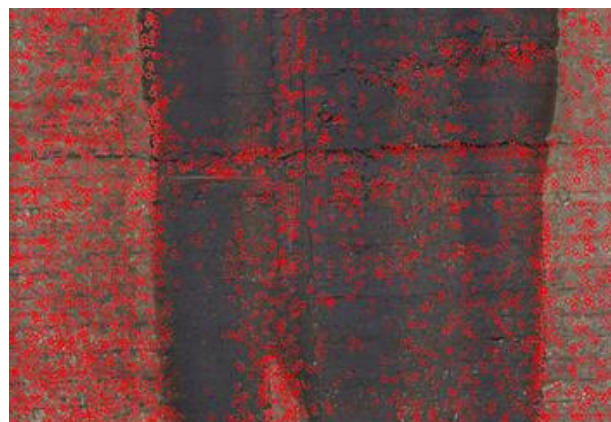
Figura 4 – Barragem da Bouça, paramento de jusante com uma zona molhada
