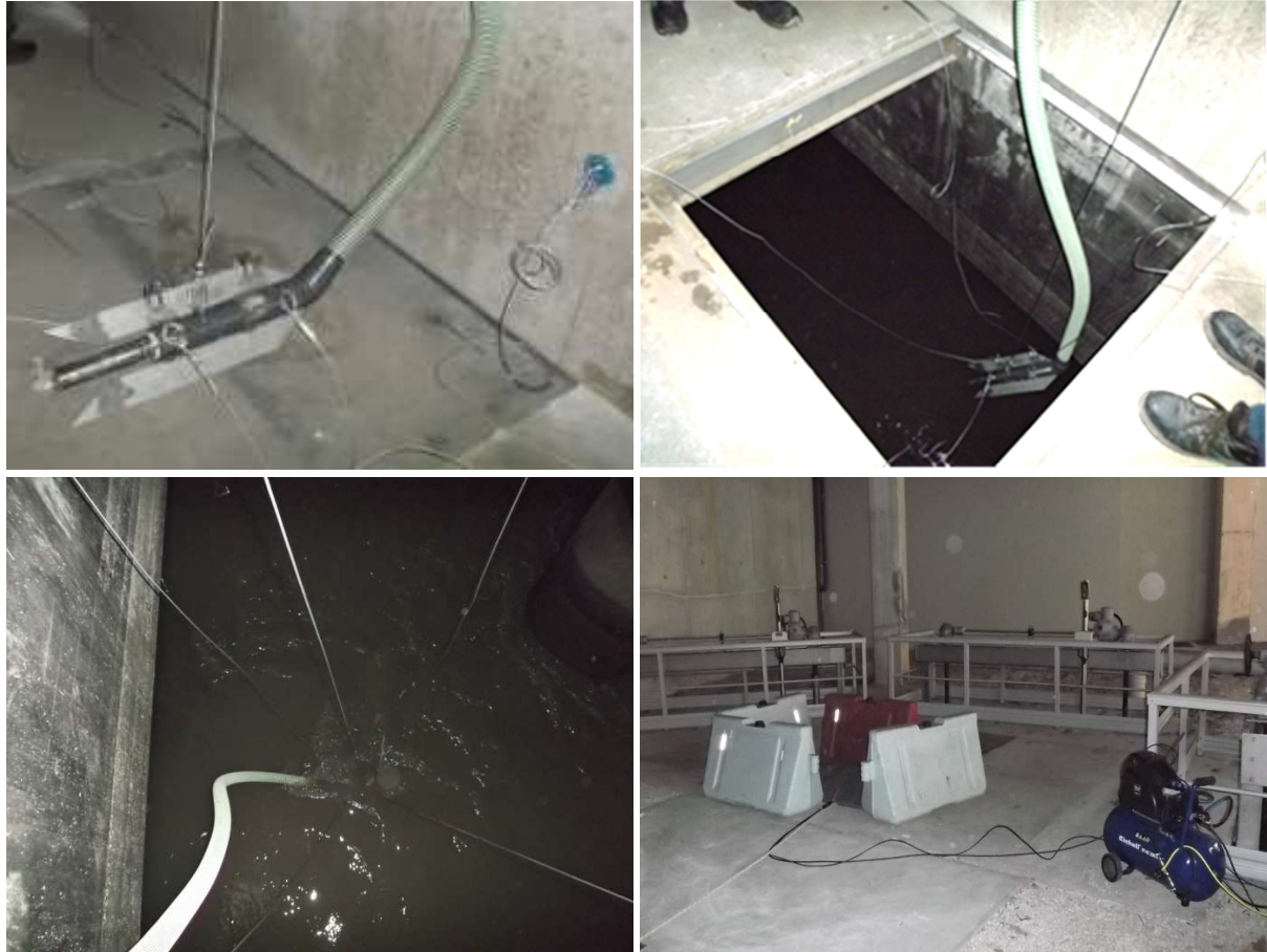
Figura 1. Local de instalação da sonda e do compressor e estrutura de suporte para a sonda.
