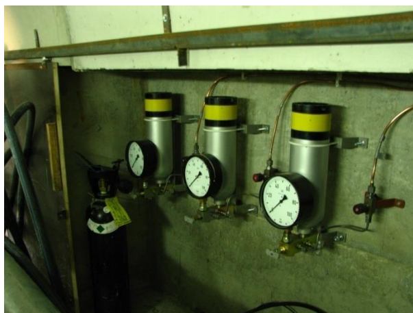
Figura 4.16 - Sistema de carga acessível no nicho
