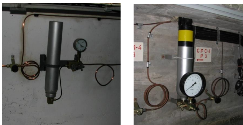
Figura 2.10 – Aspectos dos equipamentos aparentes dos sistemas de carga de células de fluência das barragens de Alqueva (esquerda) e do Alto Lindoso (direita)
