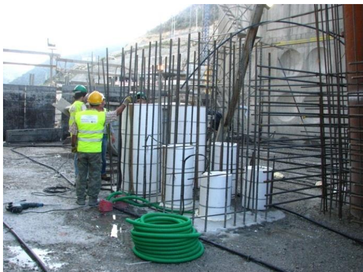
Figura 2.19 – Vista, antes da betonagem, de um conjunto de células de fluência da barragem de montante do Baixo Sabor
