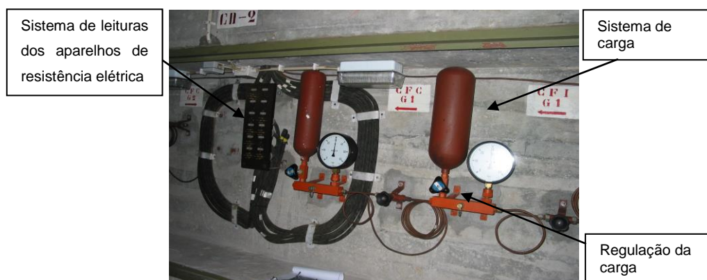
Figura 2.9 – Vista do sistema de leitura e dos equipamentos aparentes dos sistemas de carga localizados num nicho em galeria da barragem do Torrão
