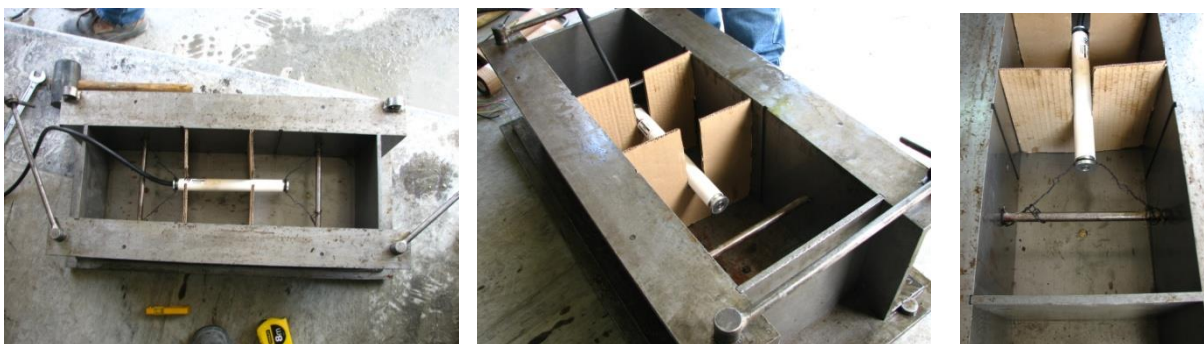
Figura 4.3 – Instalação de extensómetros do tipo Carlson no interior dos moldes prismáticos com recurso a bitolas
