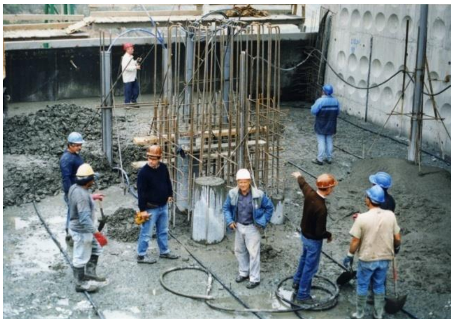
Figura 2.8 – Vista da instalação de um conjunto de células de fluência da barragem de Alqueva
