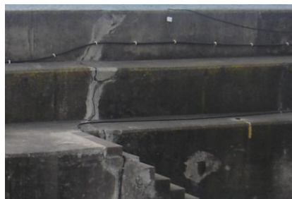
Figura 1– Fendas Identificadas na superestrutura.
