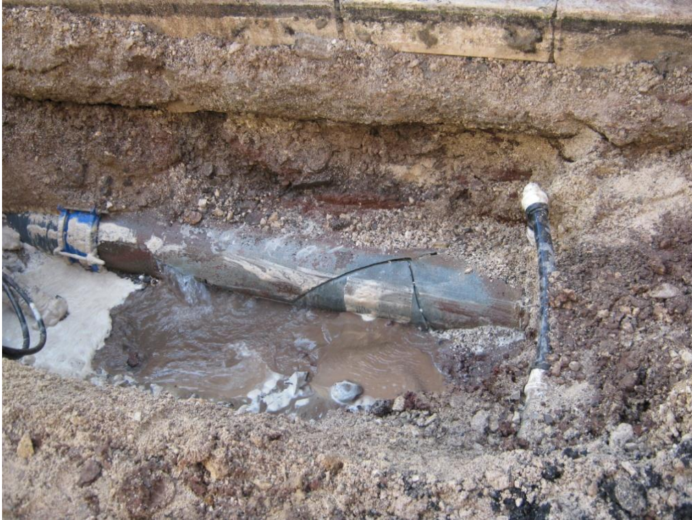
Figura 5. Rotura em conduta, imediatamente após a sua deteção
