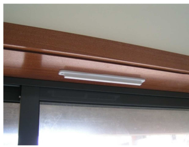
b) Grelha autorregulável instalada nos quartos e sala.
