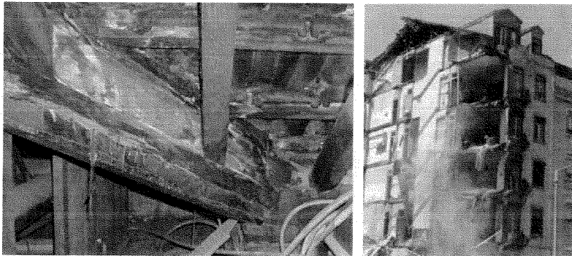
(a) (b) Figura 6 – Degradação da madeira por térmitas e fungos (a) e colapso parcial de edifício relacionado com degradação biológica da madeira (b).
