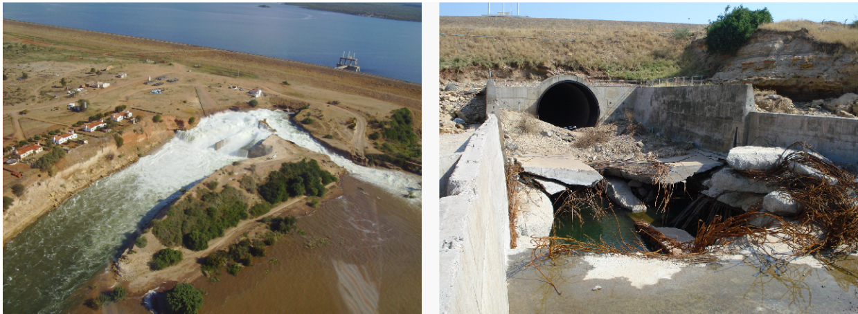
Figura 6 - Acidente na barragem (Maio de 2006) e estado final da zona da central e saídas das descargas de fundo
