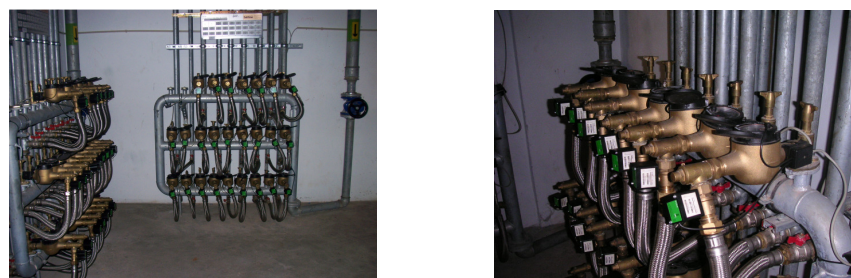
Figura 2 - Contadores instalados em bateria no complexo de edifícios Twin-Towers .
