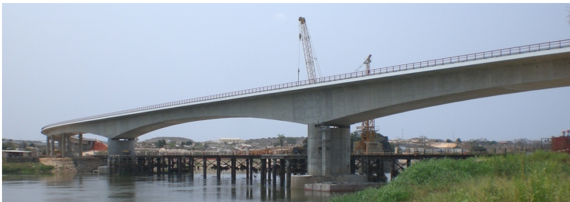
Figura 1. Vista de montante da ponte sobre o rio Kwanza no final da construção.
