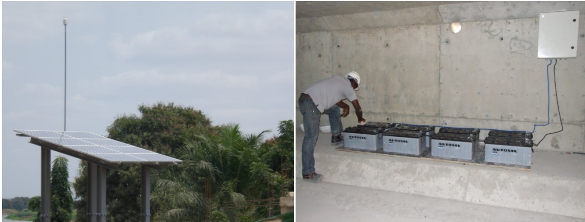
Figura 7. Alimentação eléctrica através de um sistema de painéis fotovoltaicos associados a um conjunto de baterias
