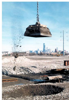
Figura 2.5 - Pormenor da aplicação da compactação profunda recorrendo a queda de grandes massas (Dynamic Compaction, 2011).
